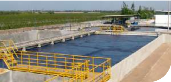
Planta de tratamiento de aguas residuales (PTAR)
