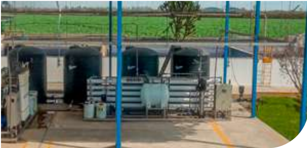
Planta de ultrafiltración y ósmosis inversa (PTAP)
