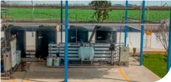
Planta de ultrafiltración y ósmosis inversa (PTAP)
