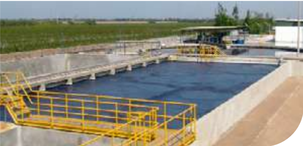
Planta de tratamiento de aguas residuales (PTAR)
