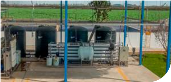
Planta de ultrafiltración y ósmosis inversa (PTAP)
